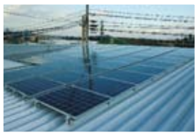
就労支援事業所 Worksみらいへ電力供給中のパネル
